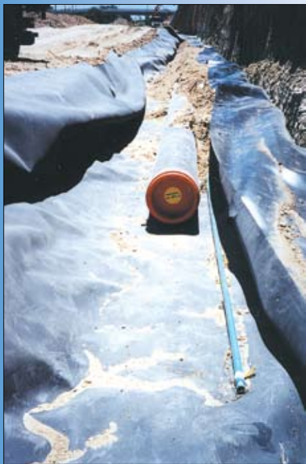
大型国际机场航空燃油传输管道的用于安装TT5000的蓝色PVC开槽管道。
